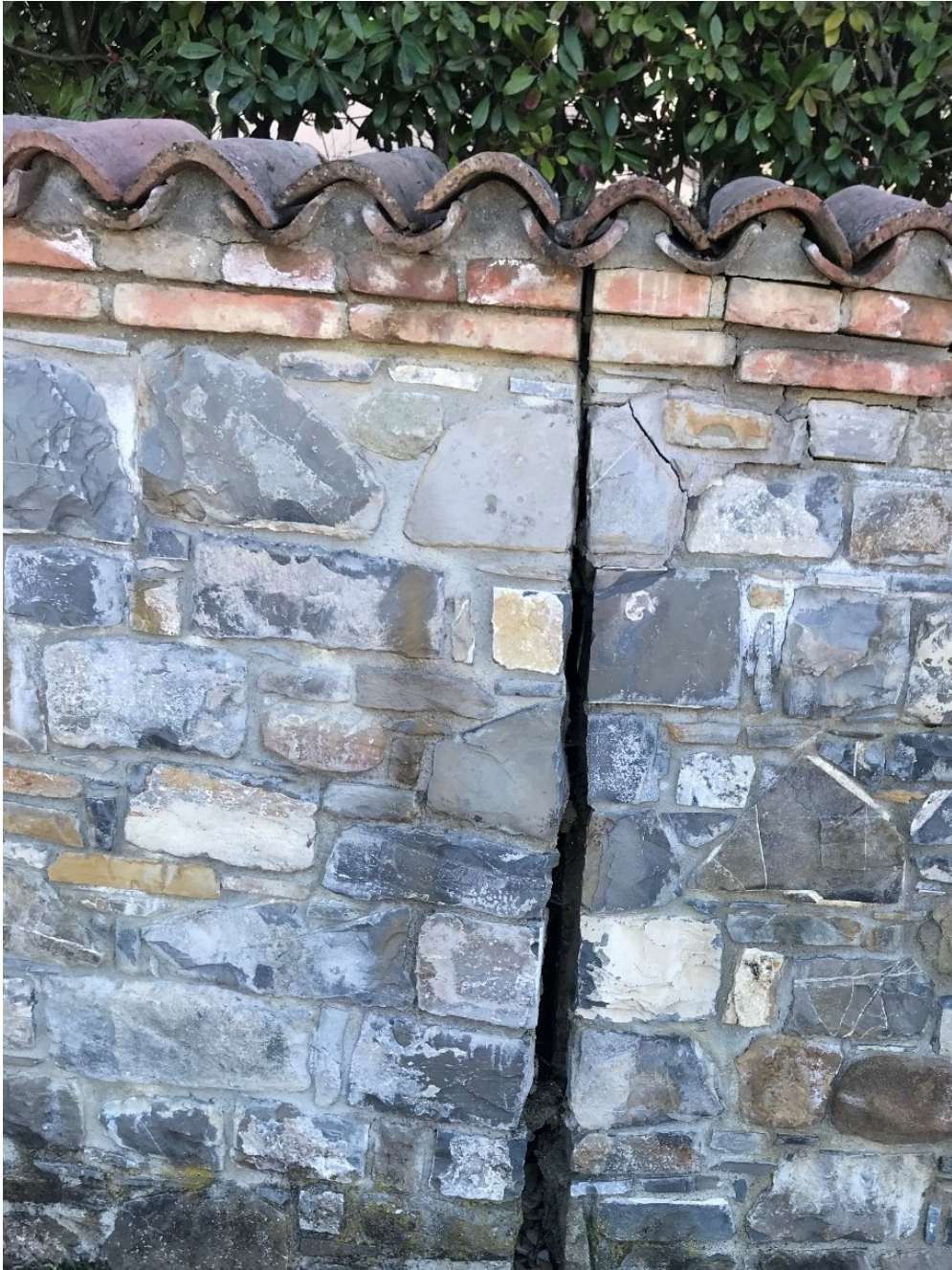
Lesioni su muro di contenimento
