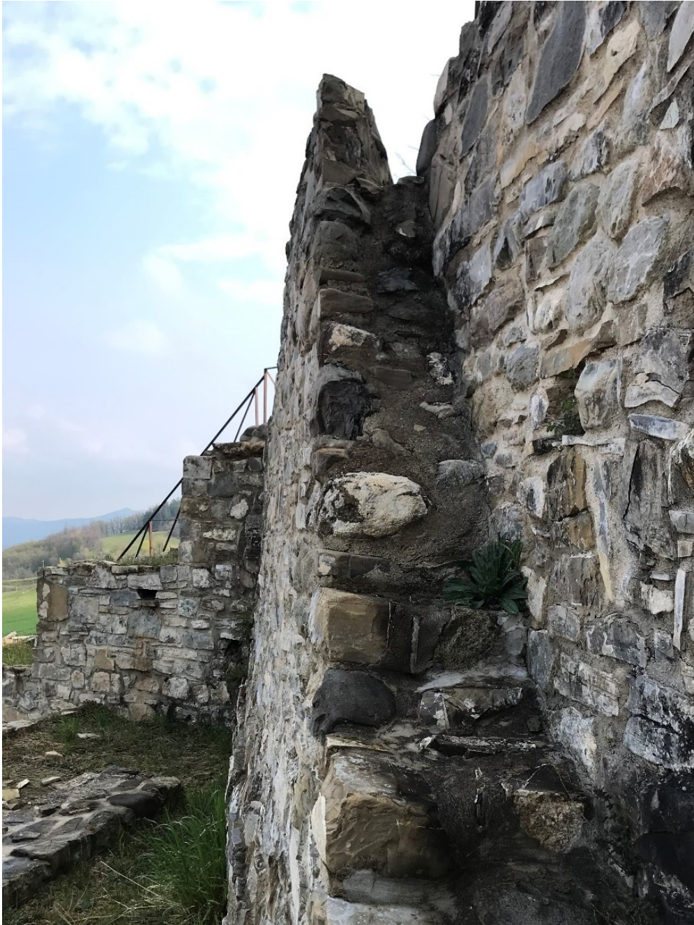
Dislocazione nel muro perimetrale (40 cm) causata dal movimento della frana (Settembre 1920?), sovente scambiata per scala di accesso
