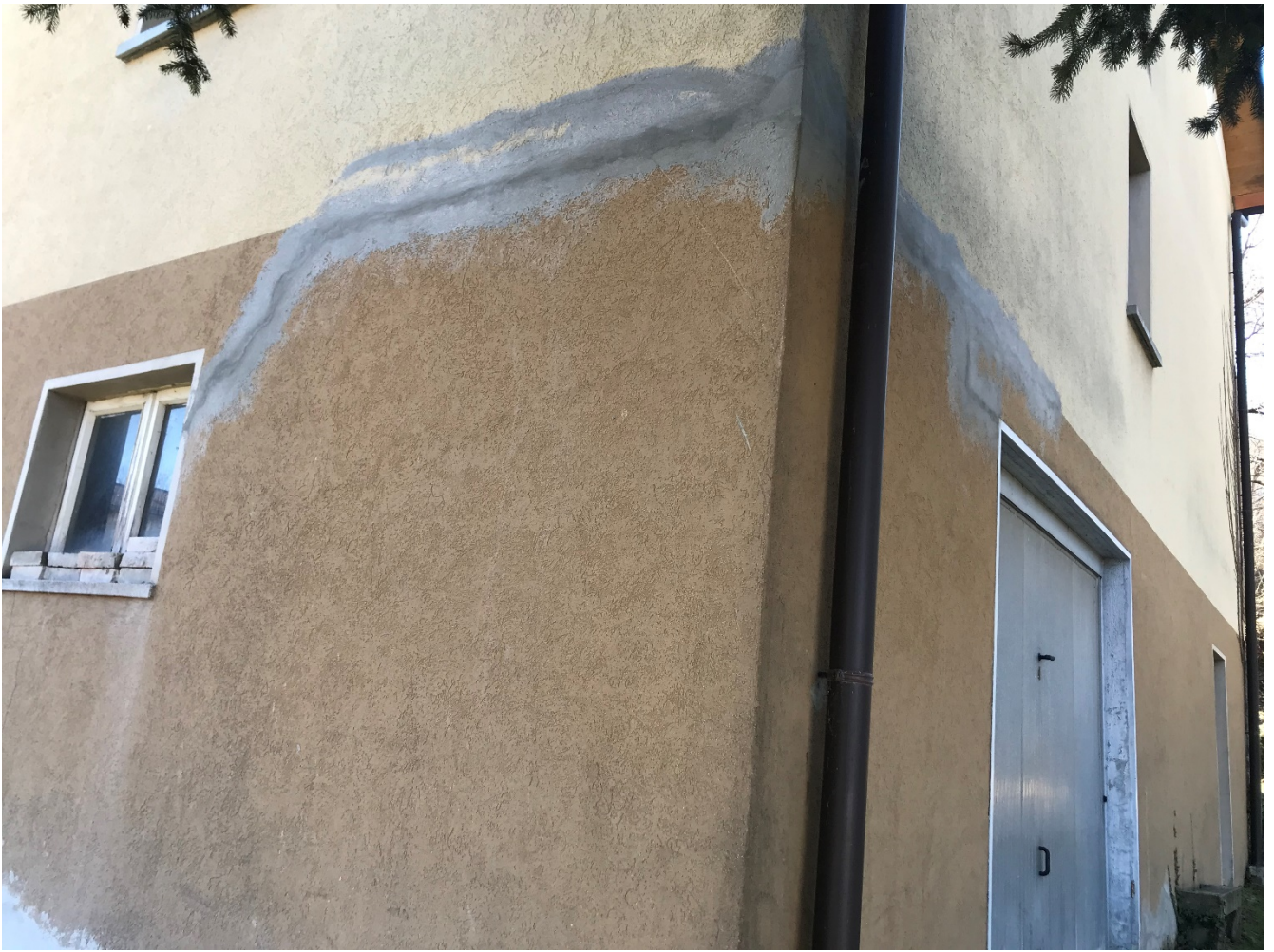
Lesioni su fabbricato
