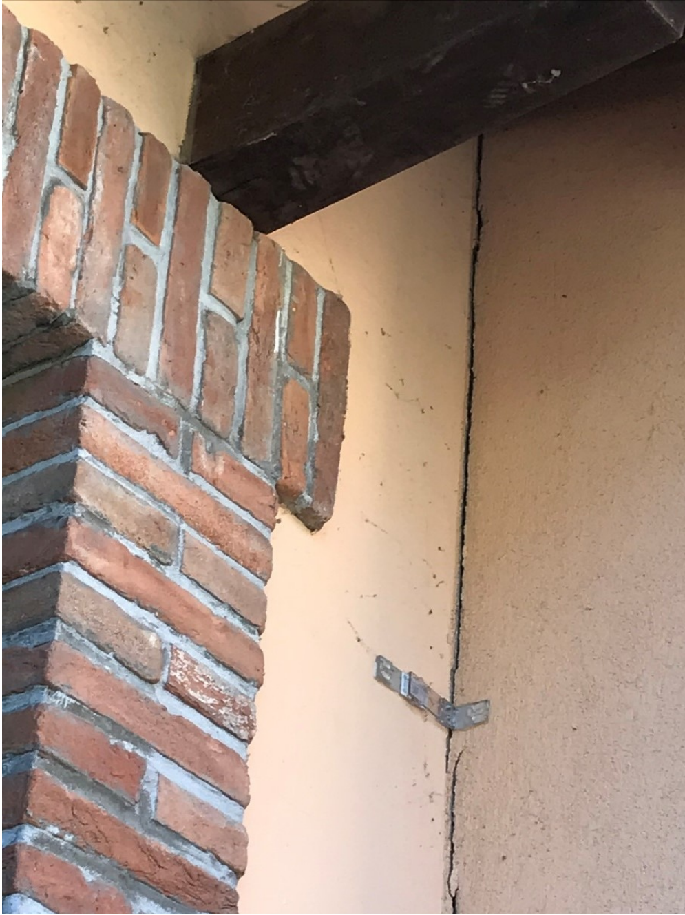
Lesioni su fabbricato
