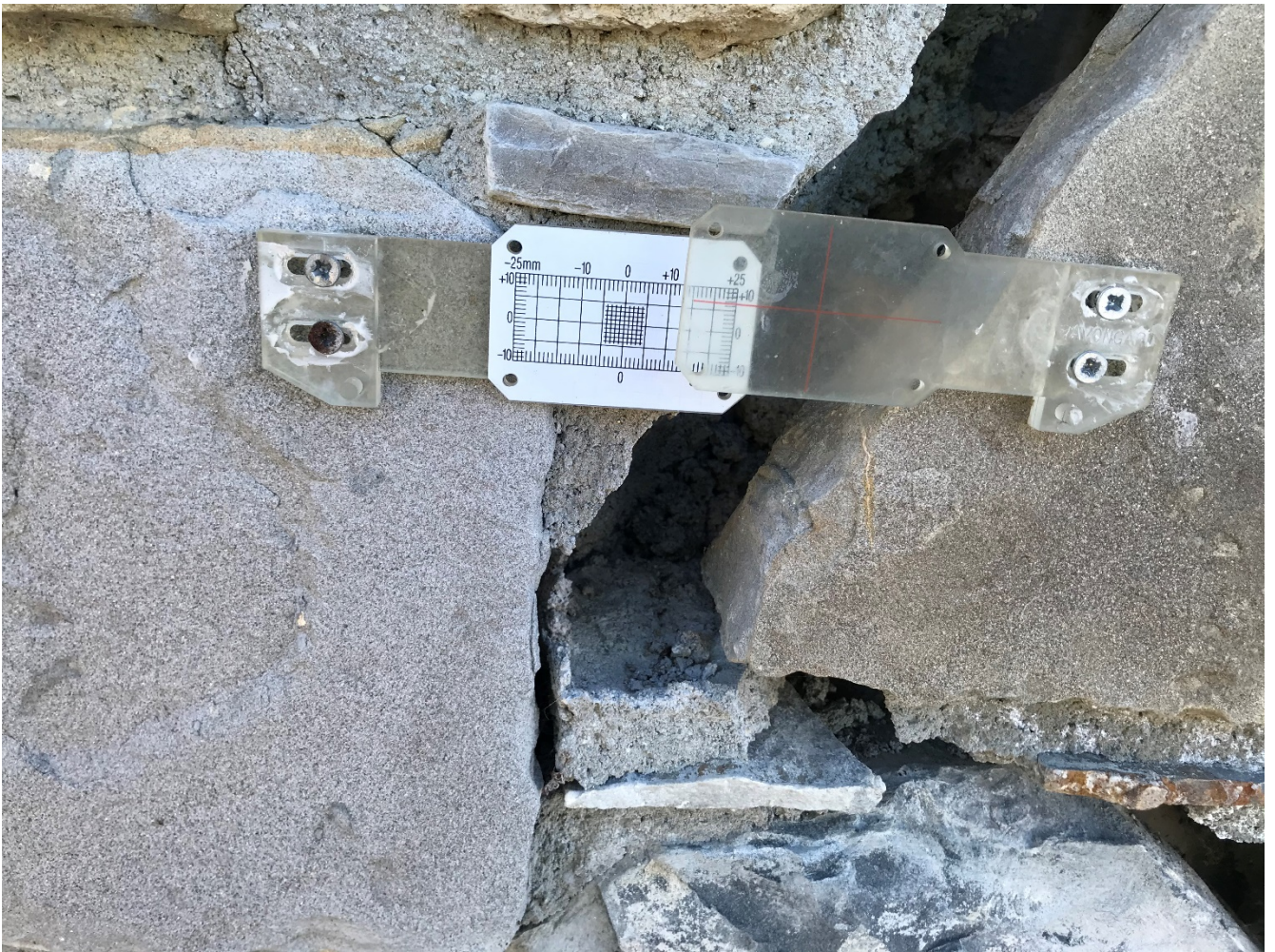
Lesioni su muro monitorate con “vetrino” o fessurimetro
