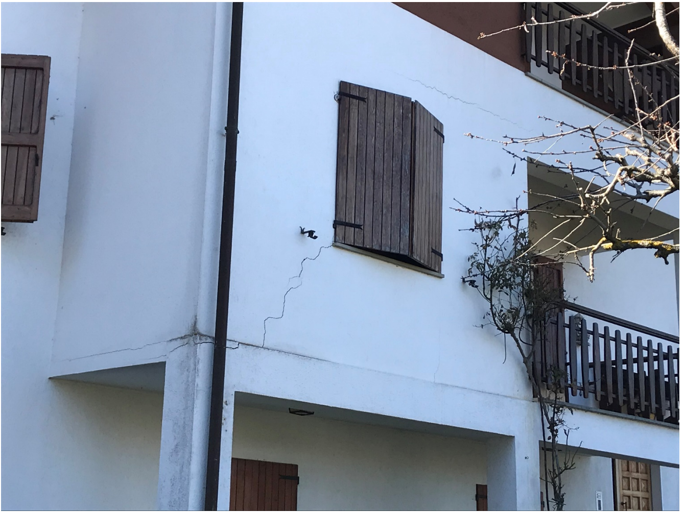
Lesioni su fabbricato
